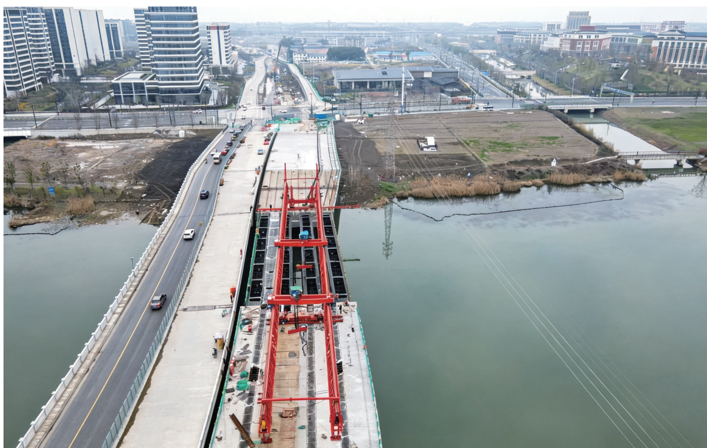
项目2标段北横港大桥左幅最后四片钢混组合梁顺利架设完成。
